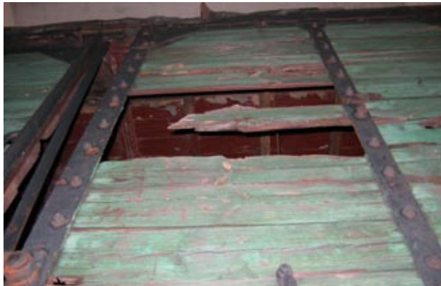
Vista de faltantes en la madera.
