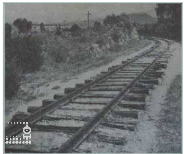
Deterioro de la vía en el Kilómetro 14, próximo a la estación La Cima. 49
